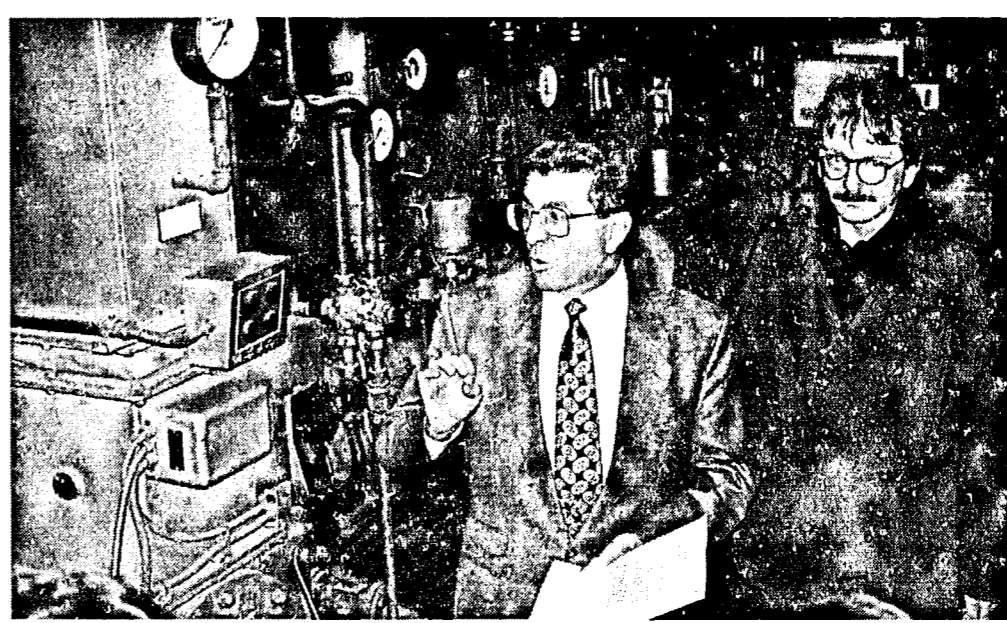
Landrat Josef Lach (l) und sein Pressesprecher, Dr. Rüdiger Schlaga, im neuen Blockheizkraftwerk des Dreieich-Krankenhauses.
